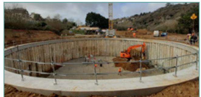
Bassin tampon construit rue du Légué à Saint-Brieuc pour éviter les rejets du système d'assainissement en temps de pluies
